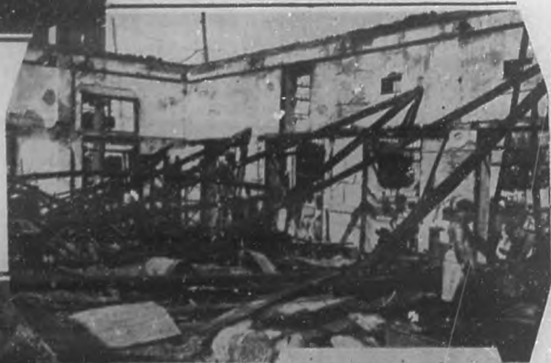
Aspecto de lo que quedó de la casa Alameda esquina a Ayuntamiento, después de sofocado el violento incendio que la destruyó.
